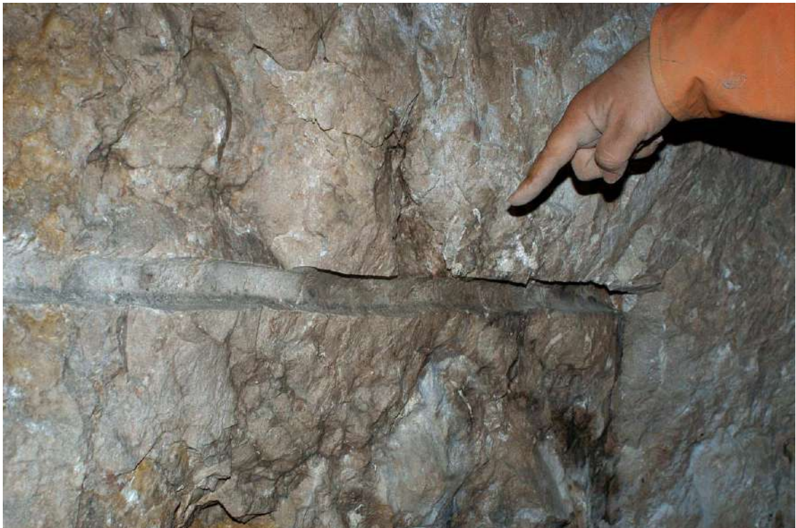
Fig. 8 - Impronta di carotaggio, realizzata probabilmente per l'alloggiamento di una micro-carica esplosiva. Fig. 9 - Impronta di ulteriore carotaggio, presente in parete a circa 70 centimetri dal suolo. Gli accumuli di pietre a spigoli vivi alla base di tali solchi artificiali attestano che una certa quantità di roccia è stata disgregata artificialmente.
